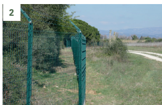
1. Développement de plantes ligneuses en pied de clôture. Aéroport de Dinard
