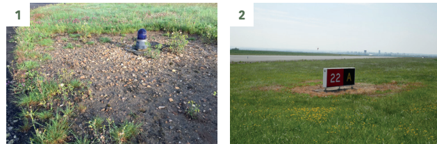
1. Balise lumineuse basse traitée au désherbant total deux fois par an. Aéroport d'Orléans ©Aéroport d'Orléans. 2. Panneau de signalétique avec socle béton dont le pourtour est traité au désherbant total une à deux fois par an. Aéroport de Beauvais
